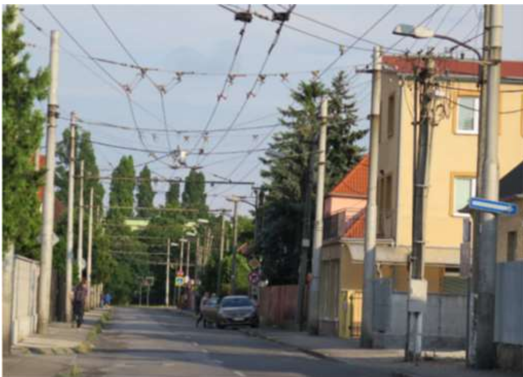
. 86 - Osvetľovacia sústava na trakčných stožiaroch na Rádiovej ul.
