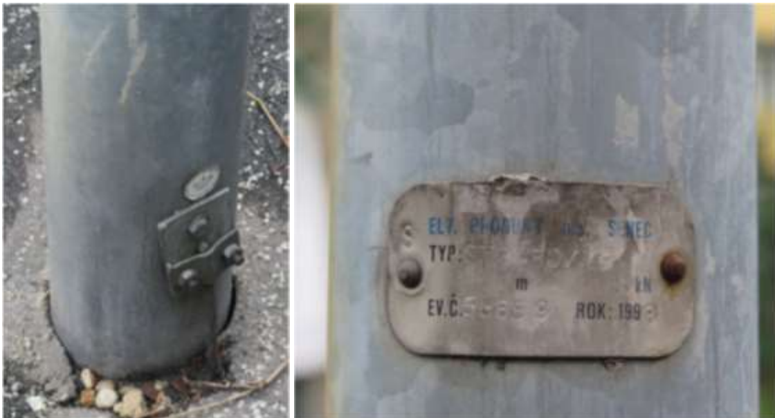
Obrázok č. 71 - Detail uzemnenia a detail štítka pozinkovaného stožiara z roku 1998 v Ružovej doline
