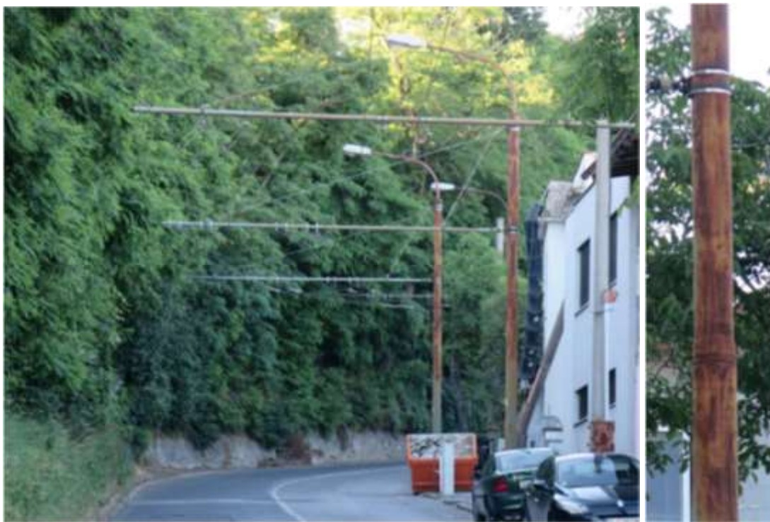
Obrázok č. 68 - Kompletne skorodované trakčné stožiare na ul. Jaskový rad
