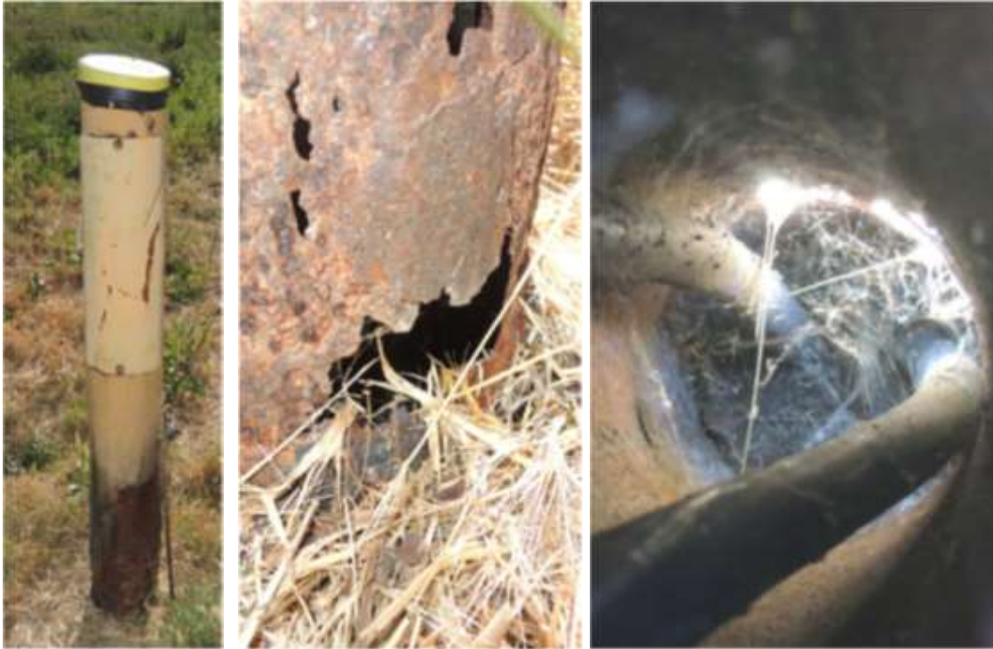
Obrázok č. 67 - Zrezaný stožiar na Jasovskej ul. s detailom vážneho poškodenia koróziou
