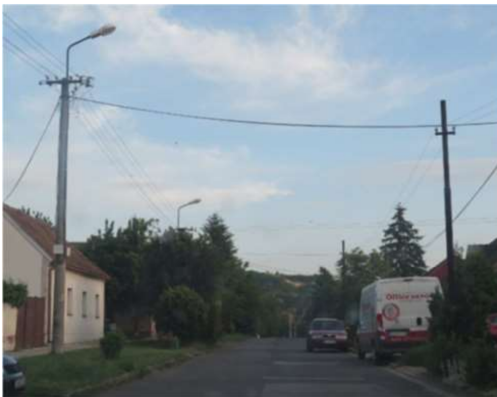
Obrázok č. 89 - Osvetľovacia sústava na distribučných stožiaroch na ul. Na Grbe: svietidlá inštalované nad holými vedeniami
