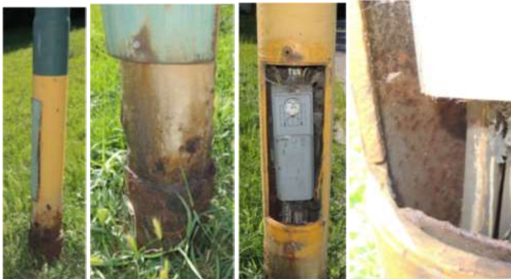
Obrázok č. 63 - Intenzívna korózia spodku stožiaru č. 049/007 na ul. Pod Rovnicami
