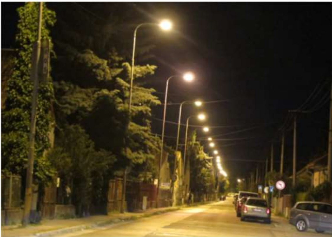
Obrázok č. 110 - Rovnomerné osvetlenie pomocou vysokých stožiarov na Železničnej ulici
