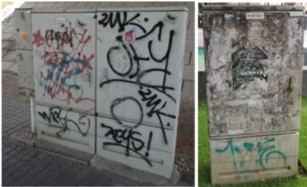
Obrázok č. 95 - Pokreslené a znečistené skrinky rozvádzačov RVO v dôsledku vandalizmu
