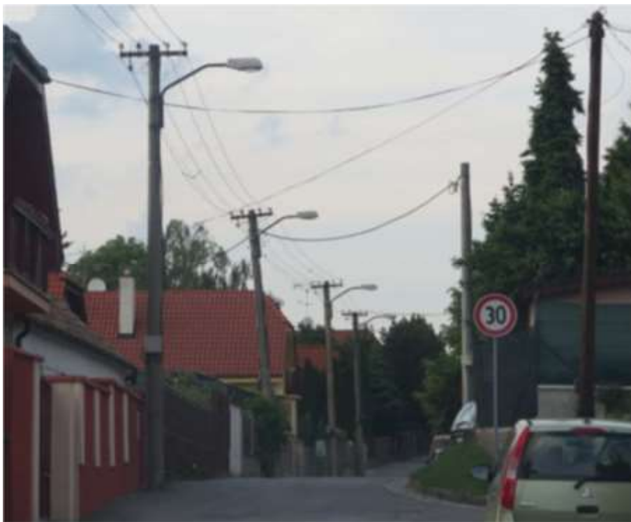
Obrázok č. 87 - Osvetľovacia sústava na distribučných stožiaroch na Donskej ulici: svietidlá inštalované pod holými vedeniami
