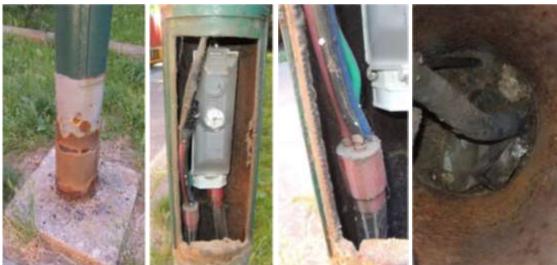
Obrázok č. 64 - Korózia spodku stožiaru č. 049/020 na ul. Pod Rovnicami
