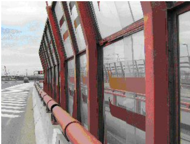
Príklad protihlukovej bariéry na diaľnici v Bratislave
